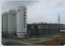
Local LNG storage tank
